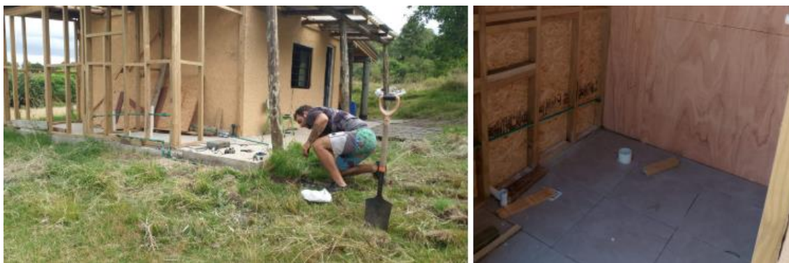
Ilustración 18 - Colocación de caño de abastecimiento de PEAD e instalación de caños de termofusión
